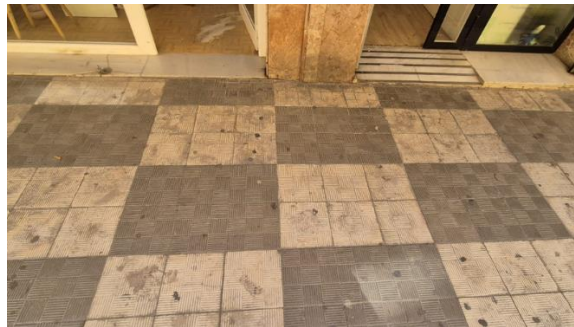
CALLE JONÁS. SUCIEDAD EN LA ACERA
