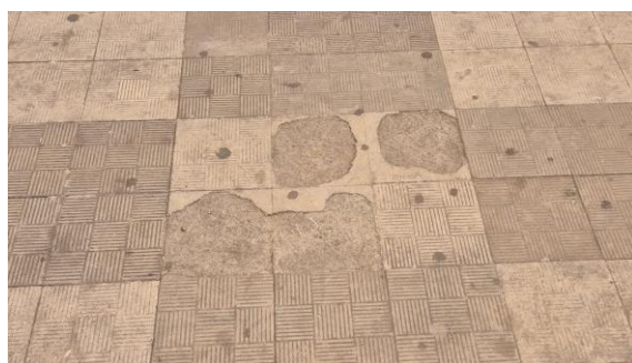
CALLE JONÁS. BALDOSAS DESGASTADAS POR EL USO
