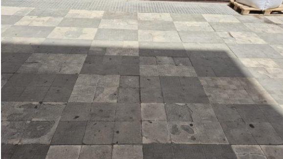
CALLE JONÁS. BALDOSAS DESGASTADAS POR EL USO
