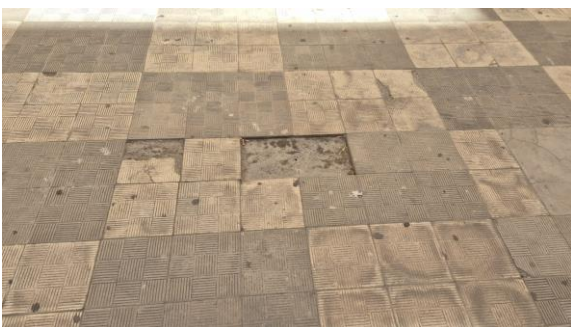
CALLE JONÁS. BALDOSAS ROTAS O AUSENCIA DE ELLAS, BORDES PELIGROSOS
