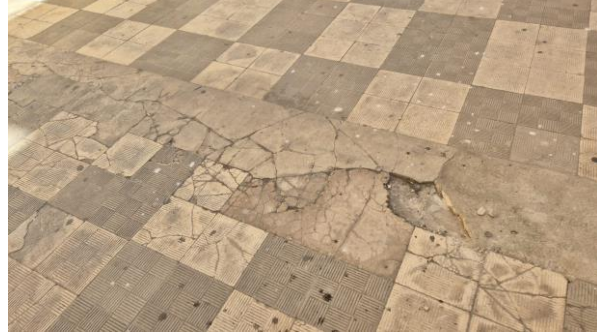
CALLE JONÁS. ACERA REPARCHEADA
