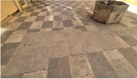
CALLE JONÁS. ACERA REPARCHEADA
