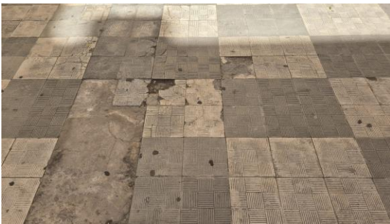
CALLE JONÁS. ACERA REPARCHEADA
