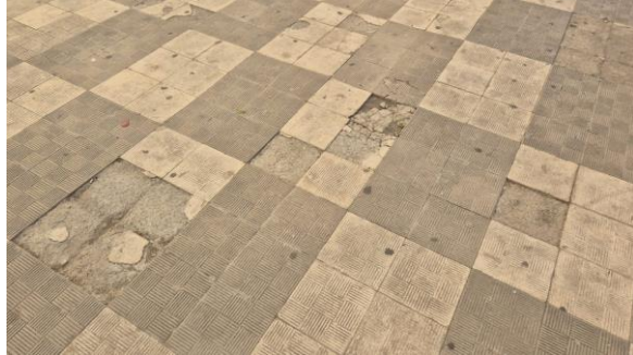
CALLE JONÁS. BALDOSAS DESGASTADAS POR EL USO
